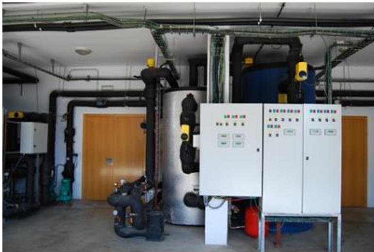
Figura 14. Sistema de acumulación de agua fría.
