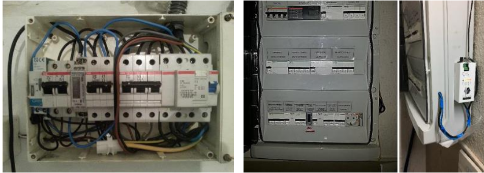
Figura 4. Medidores eléctricos en la torre y bloque para iluminación.
