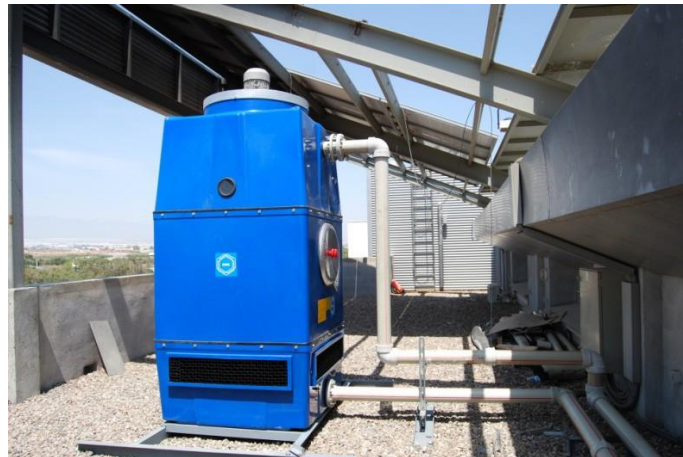
Figura 11. Torre de refrigeración Sulzer EWK 100.
